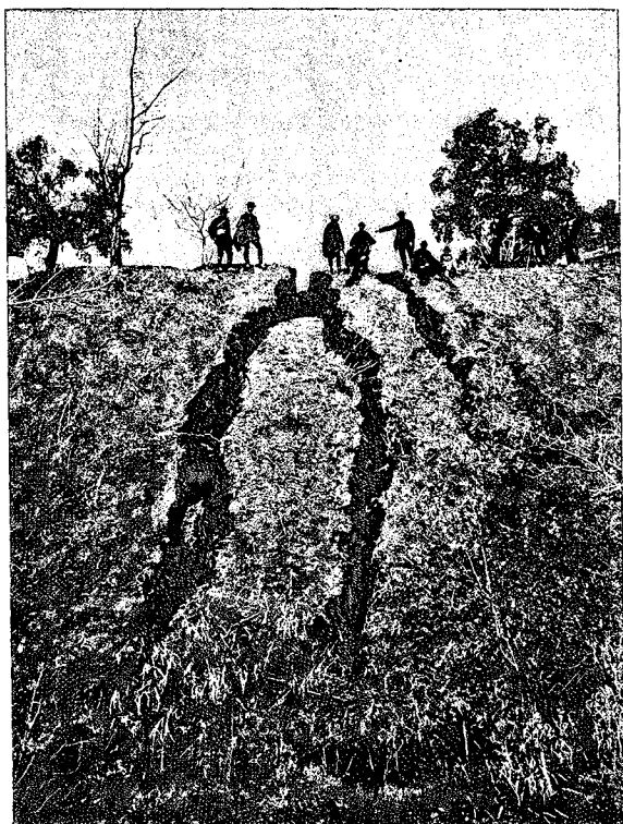
FIG. 38. — Portion de la fissure de Guevejar.
